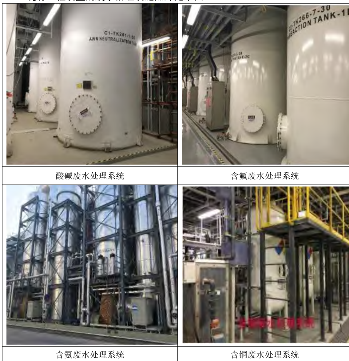
图 2-19 现有已建工程废水处理设施图
